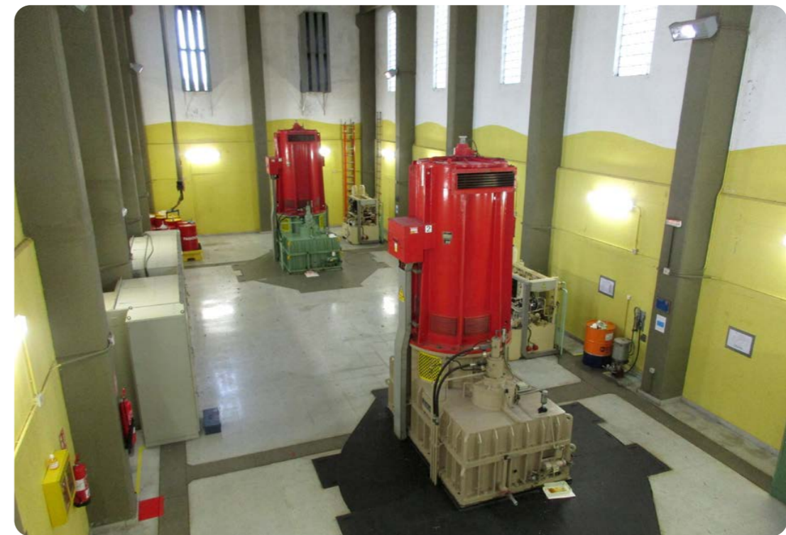
Interior de la central hidroeléctrica de Lodosa (Navarra). Autor: Silvia Cubillo Nielsen (CHE).
