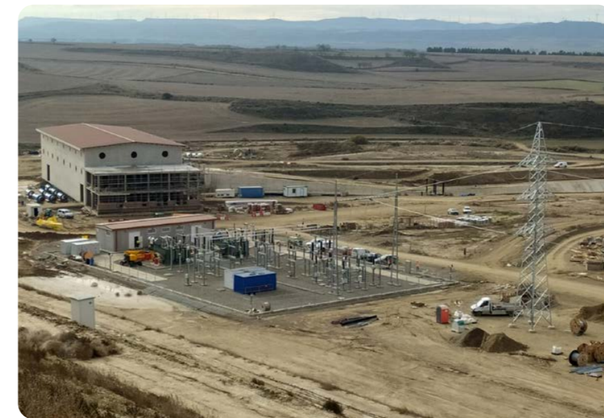
Vista de la subestación eléctrica y edificios de bombeo y de control.
