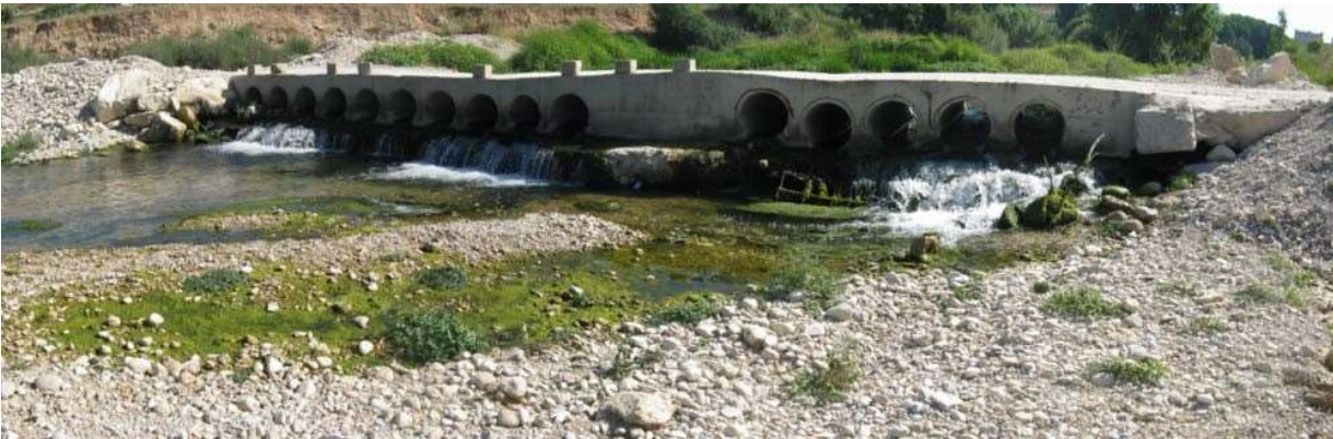
Fig. 8. Estructura transversal construida con caños circulares en el río Matarraña a su paso por Valderobres (Teruel). Esta estructura se ha descolgado del nivel del cauce imposibilitando la migración de los peces.
