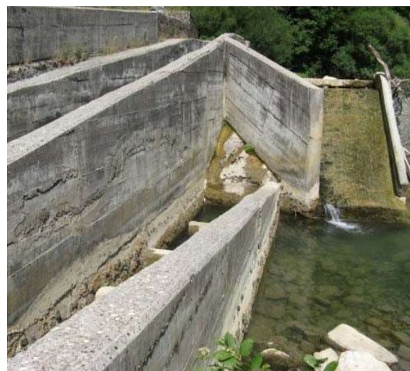
Fig. 31. Escala de peces en el río Esca (Navarra). Esta escala dispone de una mala llamada al encontrarse obstruida el rebaje realizado en el azud
