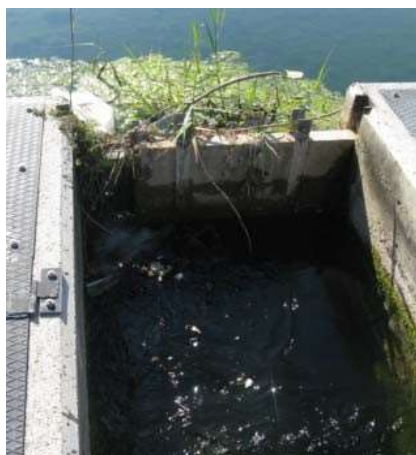
Fig. 34. Vista de la salida de un paso de peces orientada hacia la corriente la cual se encuentra totalmente obstruida. Río Matarraña en Valderrobres (Teruel).
