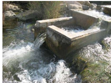
Fig. 27. Entrada descolgada de una escala de peces en el río Matarraña (Teruel)
