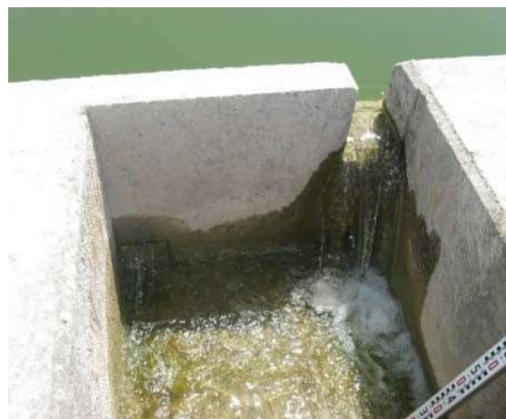
Fig. 35. Orificio de limpieza en salida de la escala obstruido con un taco de madera. Río Matarraña en Nonaspe (Zaragoza).
