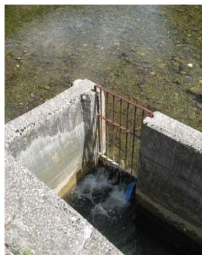
Fig. 33. Salida de una escala de peces orientada perpendicular a la corriente y con una reja para evitar la entrada de materia orgánica en el río Esca (Navarra).
