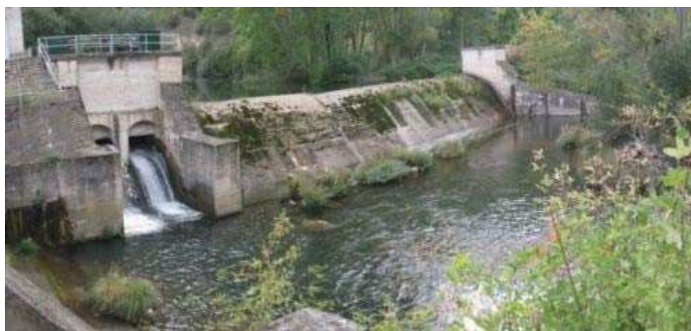
Fig. 3. Vista de un azud en el río Najerilla (T.M Anguiano, La Rioja) que cuenta con una escala de peces en la margen izquierda
