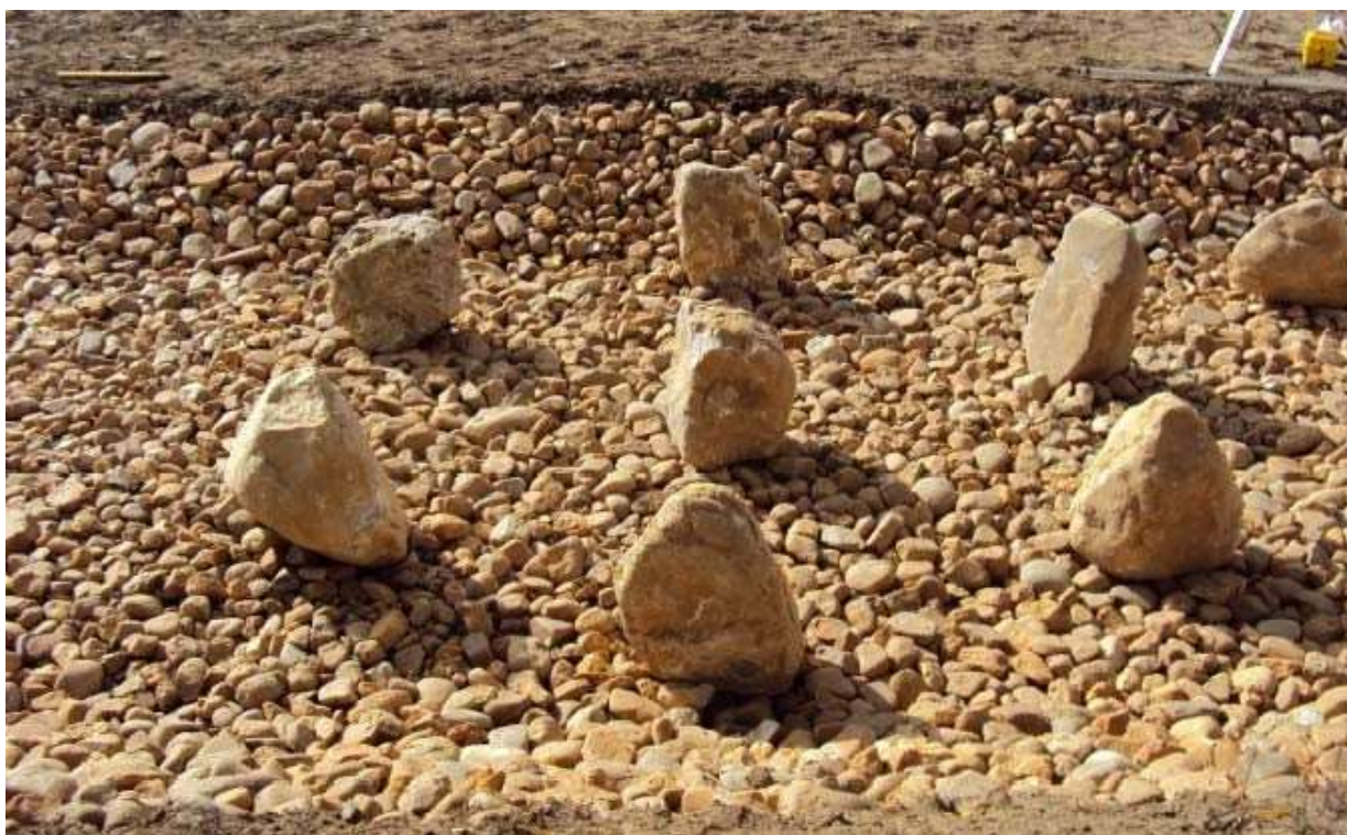
Fig. 44. Rampa de peces con incorporación de bloques en el río Tormes (Salamanca). Fuente: Sanz-Ronda
