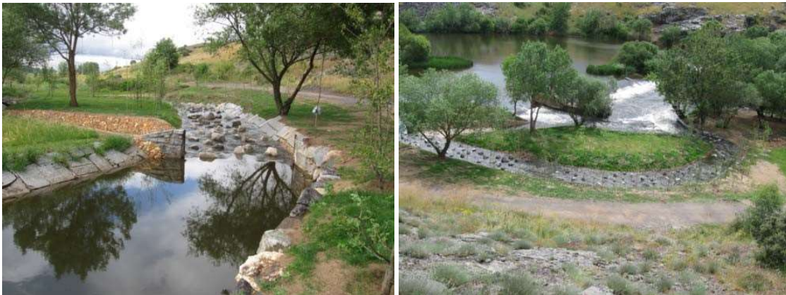
Fig. 23. Río artificial para salvar un azud en el río Tormes (Salamanca). En la imagen de la izquierda se observa en la fase de construcción y en la de la derecha en la fase de explotación. Fuente: Sanz-Ronda
