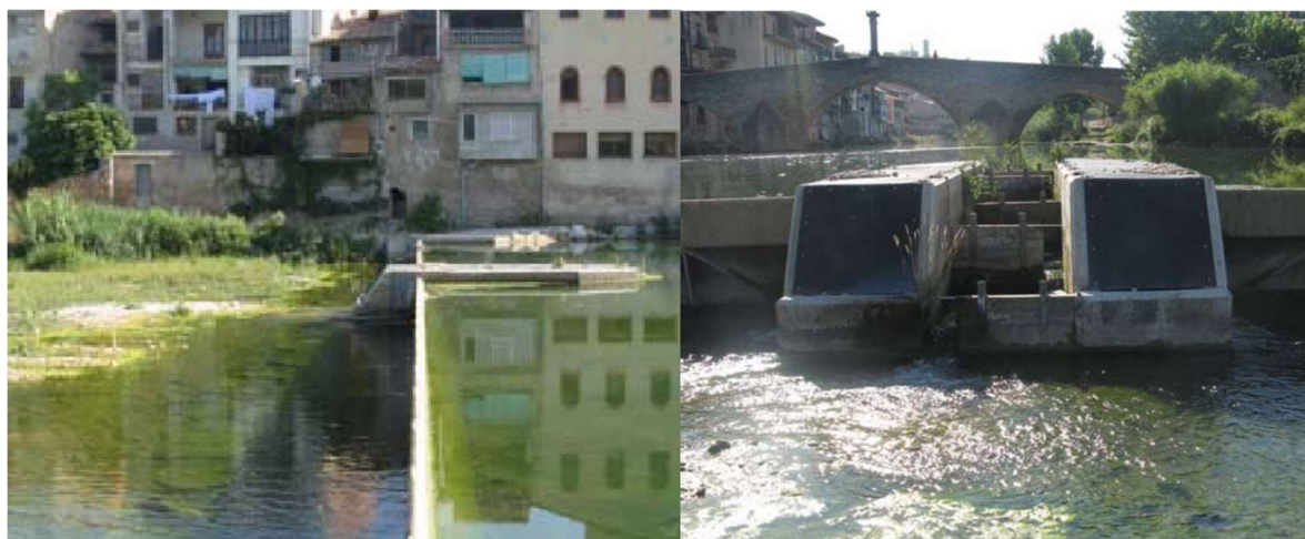
Fig. 29. Escala de peces en el río Matarraña (Teruel) mal emplazada en el centro del azud y sin caudal de llamada.
