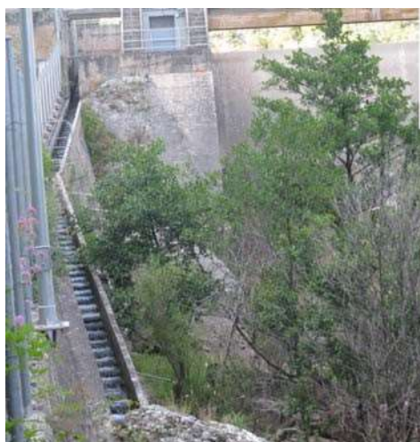
Fig. 1. Vista de la presa de Cereceda y de la escalera de peces de artesas con vertido libre construida en la margen derecha. Río Ebro (Burgos)
