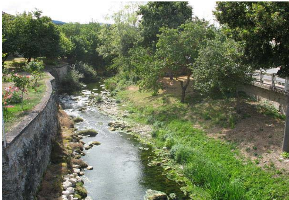
Figura 7-5. Afecciones al corredor ribereño en Villanueva de Valdegovia.
